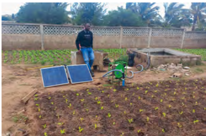
Funcionamento completo do modelo do sistema instalado, enchendo um tanque
